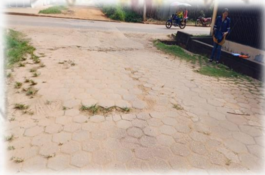
REHAB. DE VIAS Y OBRAS DE DRENAJE COMUNIDAD BAJO ACRE DEL MUNICIPIO DE (COBIJA)
